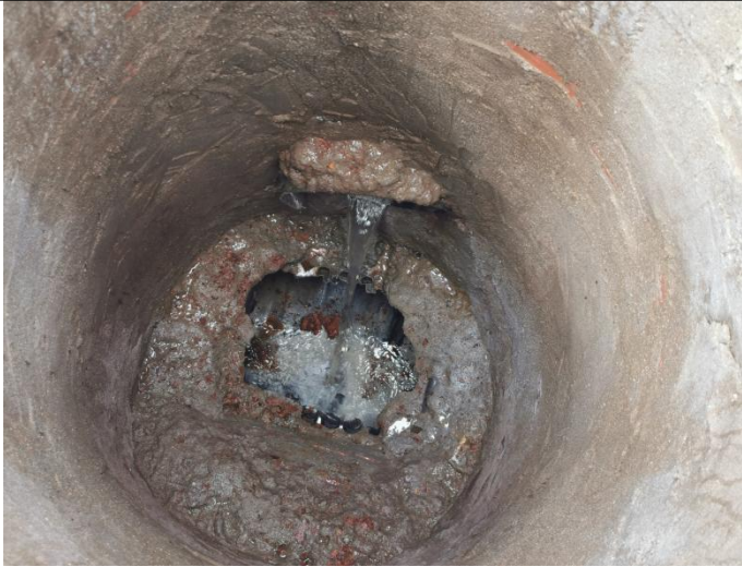
污水总排放口
