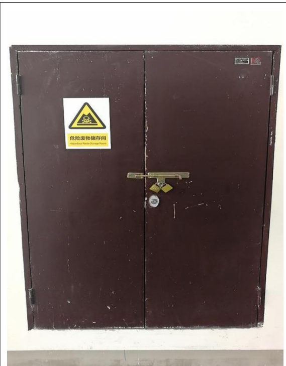
危废暂存间标识标牌
